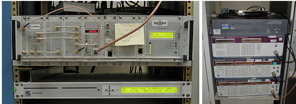
FIGURE 7.3 – Matériel installé à Plessala : faisceau hertzien émetteur (gauche) avec le modulateur OFDM et trois oscillateurs (droite)
