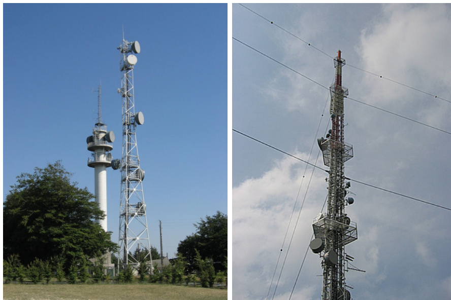
FIGURE 7.2 – Relais hertzien de Plessala (gauche) et l'émetteur de Vannes (droite)
